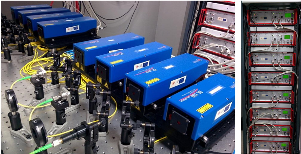
Figura 3.1: Fotografías de los láseres de diodo disponibles en el laboratorio (izquierda) y el armario rack (1.90 m de altura) con las unidades controladoras asociadas (derecha). Las imágenes no están a la misma escala.
